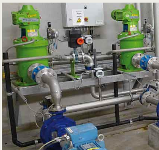
Abb. 4 Sperrwasserfiltration im Kraftwerk
