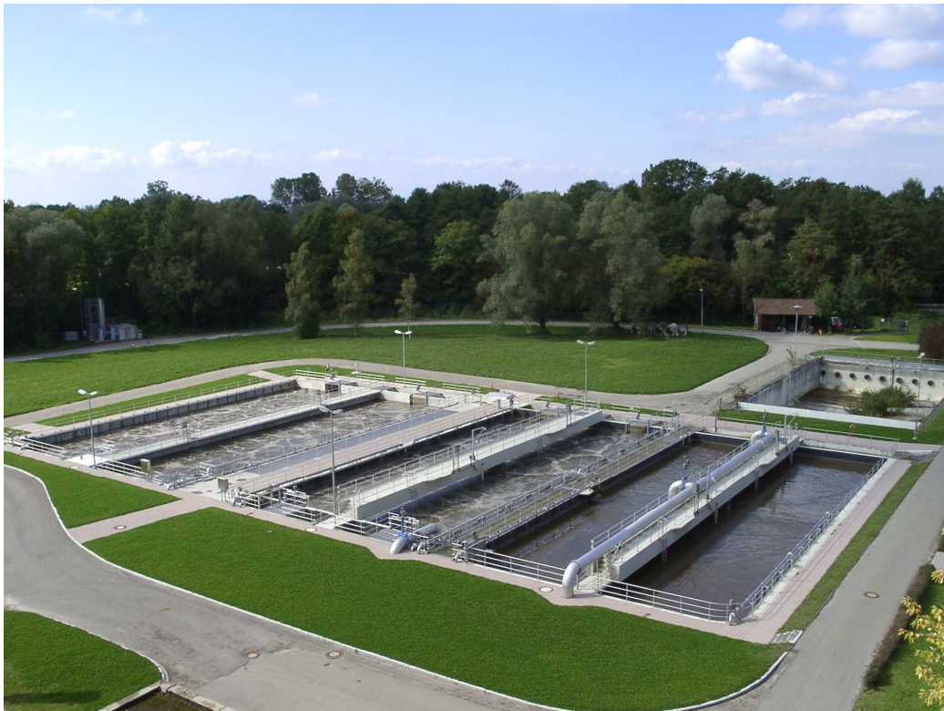
Belebungsbecken im Klärwerk
